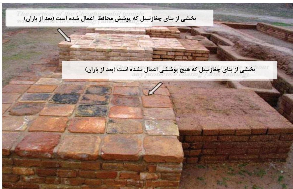
شکل ۱- پوششی از اکلیل آلکوکسی سیلوکسان برای کاهش عمق نفوذ نزولات جوی در سطح معبد چغازنبیل [۹].
